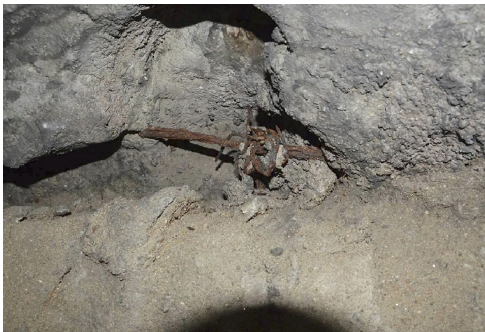
Zkorodované části kovové konstrukce Corroded sections of the steel structure
