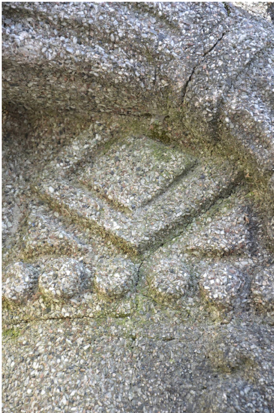
Detailní pohled na trhliny, biologické a povrchové znečištění A detailed view of cracks and biological and surface contamination
